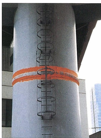
図1 高速道路の鋼製橋脚で発生した提灯座屈。橋脚の直径は約2mである。
